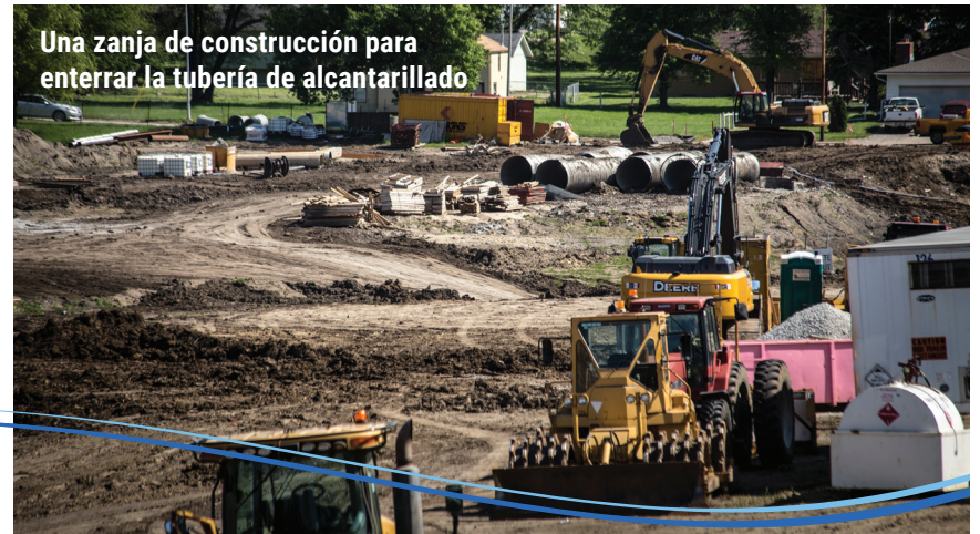
Tuberías en un centro de tratamiento
